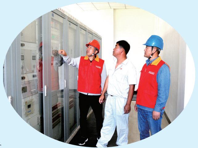
江源供电公司 of 山水水泥集团检查配电设备
