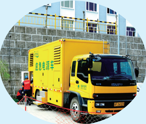
江源供电公司应急电源车作业现场
